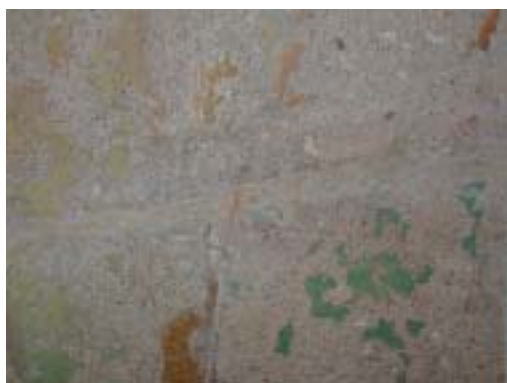
Figura 1: Macrofotografia di una regione della superficie affrescata in evidente stato di degrado; si possono individuare una linea di stucco e alcune sovrammissioni.
